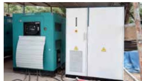
几内亚120kW光伏 + 125kW225kWh储能项目 地点：几内亚 规模：120kW光伏 + 125kW225kWh储能
