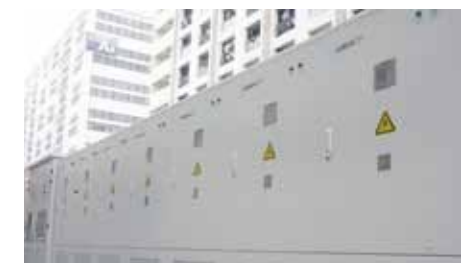
东莞中创汇智盈科技产业园1.118MW 2.236MWh用户侧储能系统项目 地点：广东省东莞市 规模：1.118MW/2.236MWh
