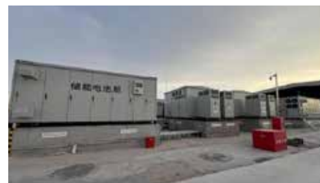
东海50MW/100MWh储能电站 地点：江苏省连云港市东海县 规模：50MW/100MWh
