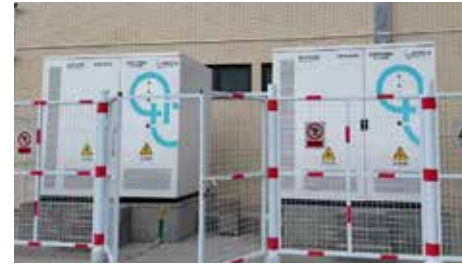
浙江义乌卓品用户侧储能项目 地点：浙江省义乌市 规模：200kW/400kWh
