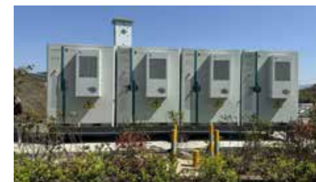
杭州富阳灰龙环保科技有限公司储能电站项目 地点：浙江省杭州市 规模：400kW/800kWh
