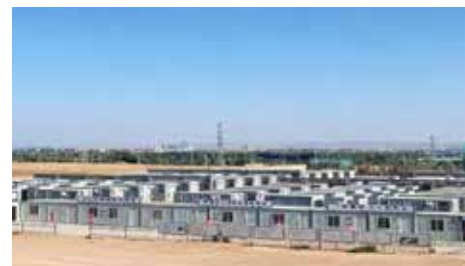
中国电建吉林院中宁县上储能源科技有限公司上储能源共享储能电站项目 地点：宁夏 规模：100MW/200MWh
