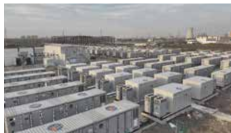
连云港市能源集团150MW/300MWh独立共享新型储能项目 地点：江苏省连云港市灌南县 规模：150MW/300MWh
