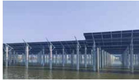
江苏洋桥200MW渔光互补光伏项目 地点：江苏连云港 规模：200MW
