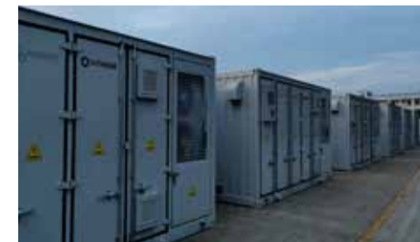
中国电建吉林院拜尔投资(宁夏)驰阳盐池100MW/200MWh共享储能电站 地点：宁夏 规模：100MW/200MWh
