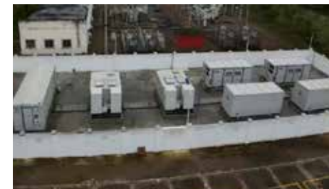
资阳市虚拟电厂绿色示范应用项目 地点：四川省资阳市 规模：25MW/50MWh
