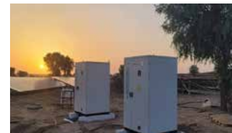
印度光伏电站配储项目储能电站 地点：印度，多地 规模：0.5-3MWh
