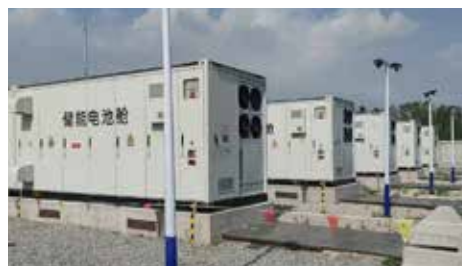
赣榆区50MW/100MWh独立新型储能电站 地点：江苏省连云港市赣榆区 规模：50MW/100MWh
